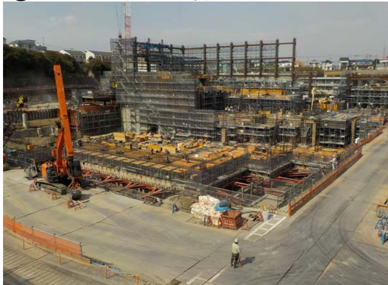
②ごみ焼却処理棟2
