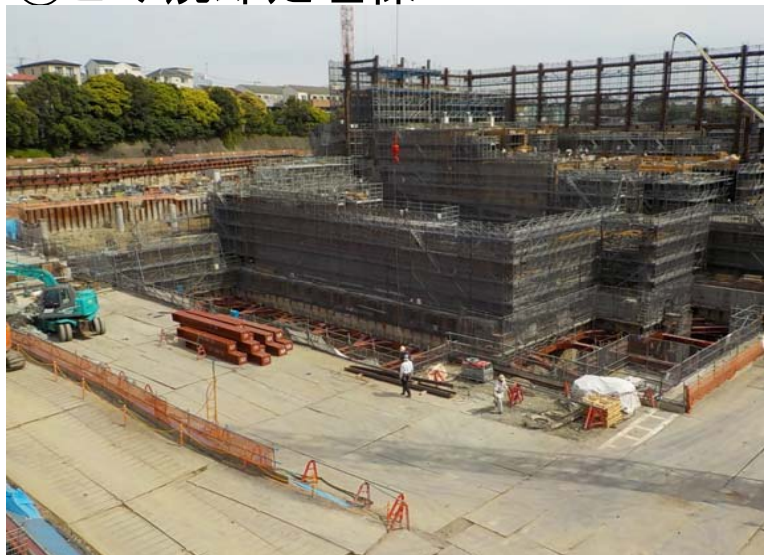
②ごみ焼却処理棟2
