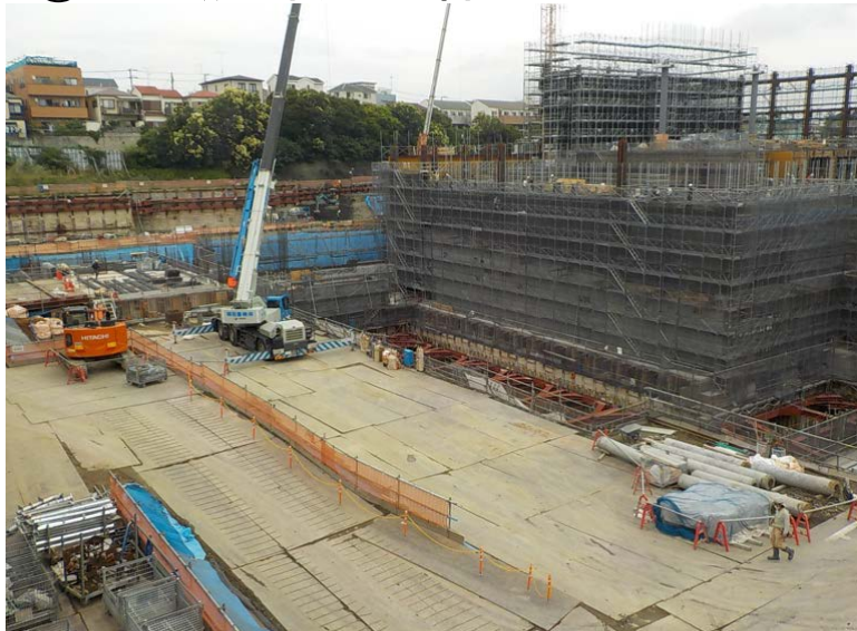
②ごみ焼却処理棟2
