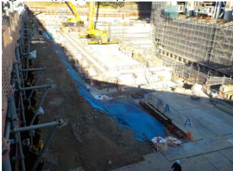
②ごみ焼却処理棟2
